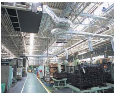
(株)小松製作所小山工場 ディスプレイースメント空調設備
