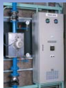
エネルギー回収システム 発電機と一体構造の水車
