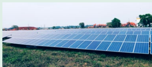
タタ日立社カラグプール工場敷地内に設置された太陽光パネル
