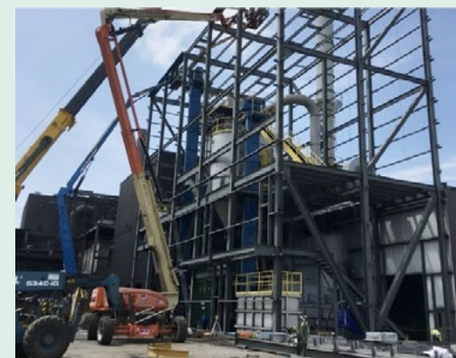
砂の再生処理装置
