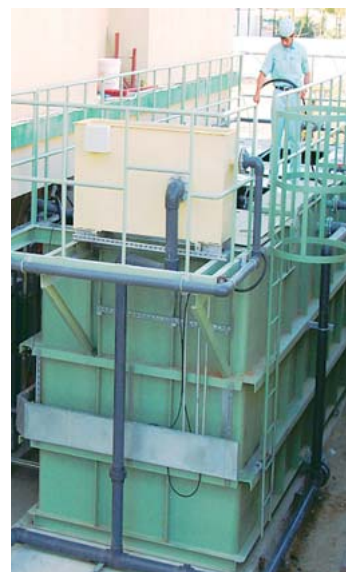
ドバイ市内レイバーキャンパス向け「ペルセウス」設備。約1,500人の生活排水を処理している
