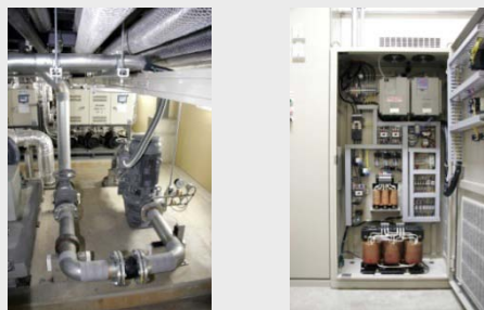
空調冷却水利用のマイクロ水力発電 水車および系統連系制御盤
