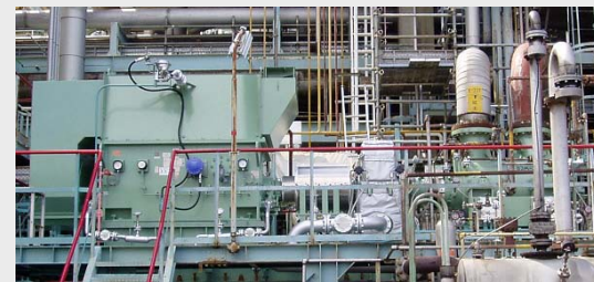
石油化学プラントにおける 蒸気タービン駆動圧縮機のモータ駆動化
